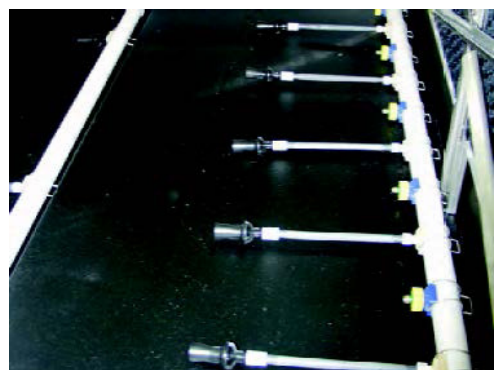
冷水盘清洗配管
